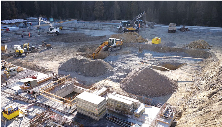
Fig. 12: Freigelegte Karsthohlräume in der zweiten Untersuchungsetappe. Davor der angelieferte Kiessand zur Verfüllung und Verdichtung (Bild Th. Rüegg, 03.11.2017).
